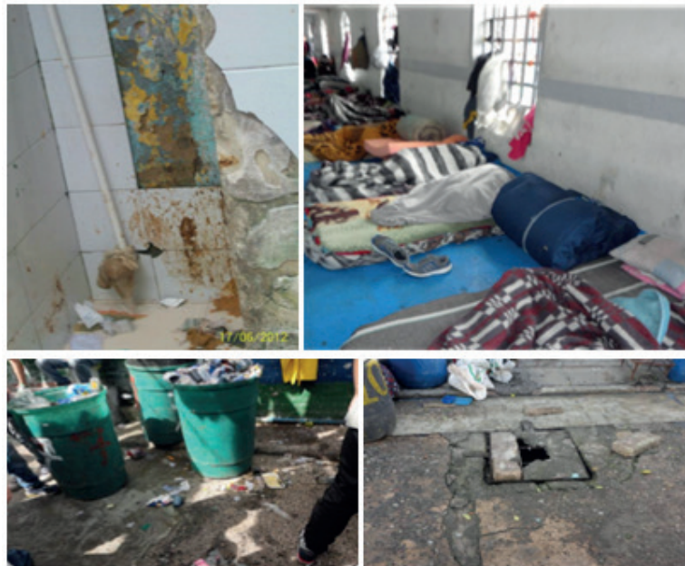
Imagen 1. Condiciones higienico-sanitarias establecimiento Penitenciario La Picota, Bogotá, septiembre de 2017
